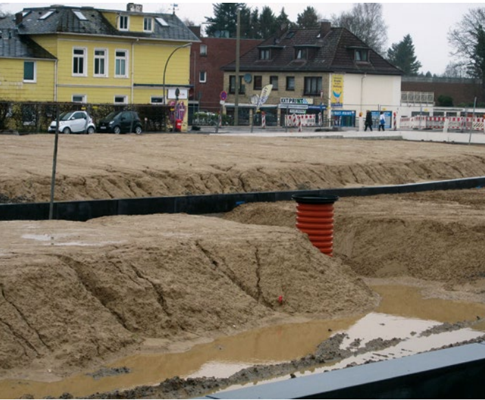
Überdeckung der Bundesautobahn 7: Hier entstehen mithilfe der Aufbringung einer flächendeckenden durchwurzelbaren Bodenschicht attraktive Grünflächen und Kleingärten.
