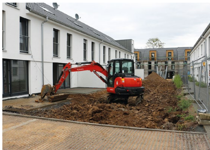
Entsiegelung und Förderung der Bodenkühlleistung: Arbeiten mit einem Minibagger auf einer späteren Grünfläche in einem Neubaugebiet
